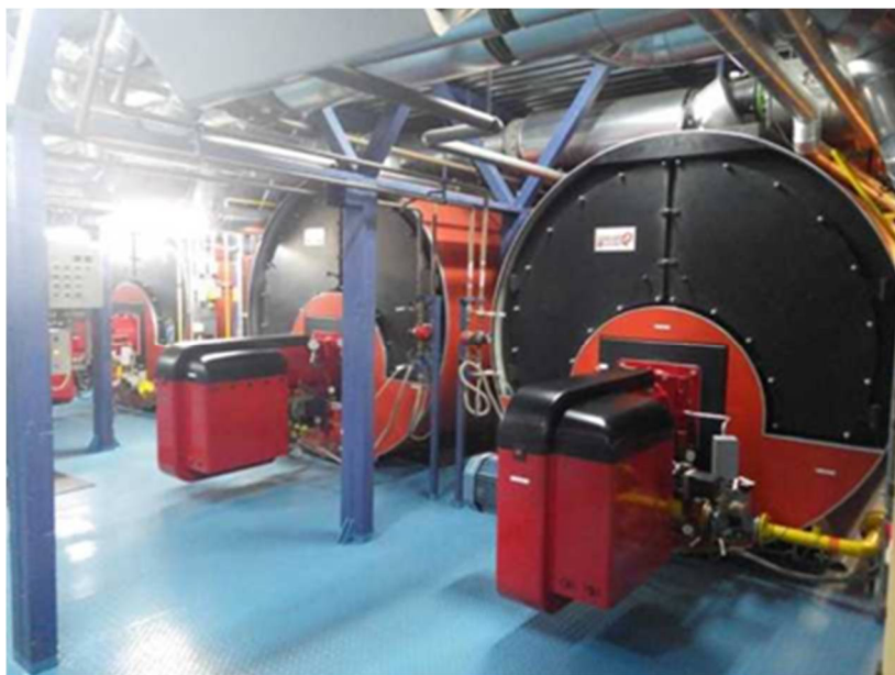
Рисунок 1.35 – Общий вид котлового оборудования котельной «Трехгорка» АО «Одинцовская теплосеть»
