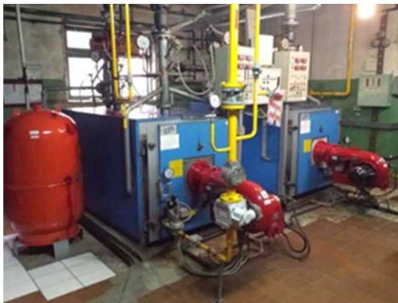
Рисунок 1.23 – Общий вид котельного оборудования котельной «Отрадное» АО «Одинцовская теплосеть»
