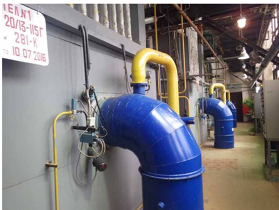
Рисунок 1.16 – Общий вид котлового оборудования котельной №7 АО «Одинцовская теплосеть»
