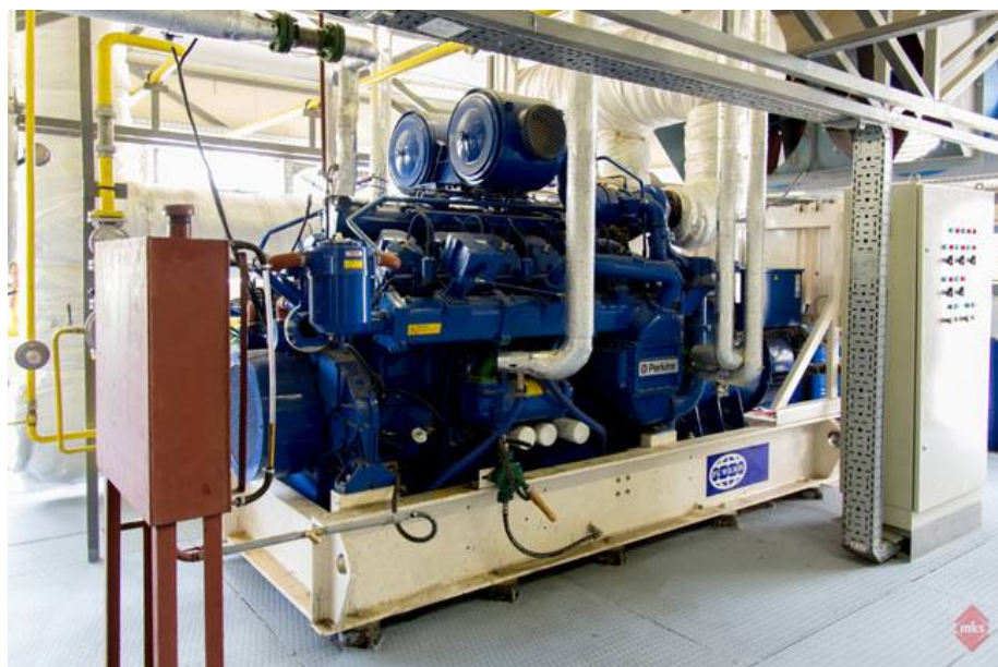
Рисунок 1.50 – Общий вид турбинного цеха мини-ТЭС ООО «УНР-858»
