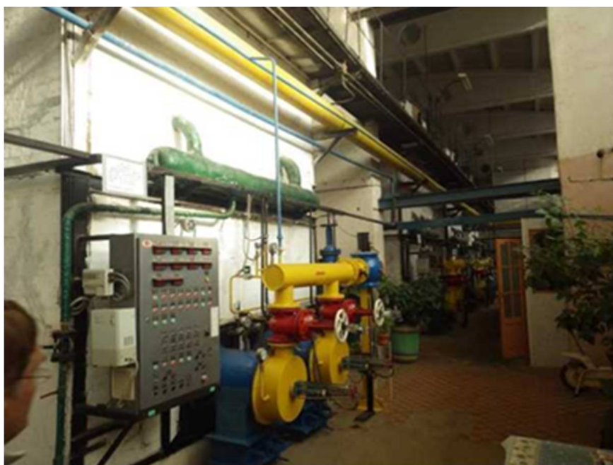
Рисунок 1.12 – Котловое оборудование котельной №3 АО «Одинцовская теплосеть»
