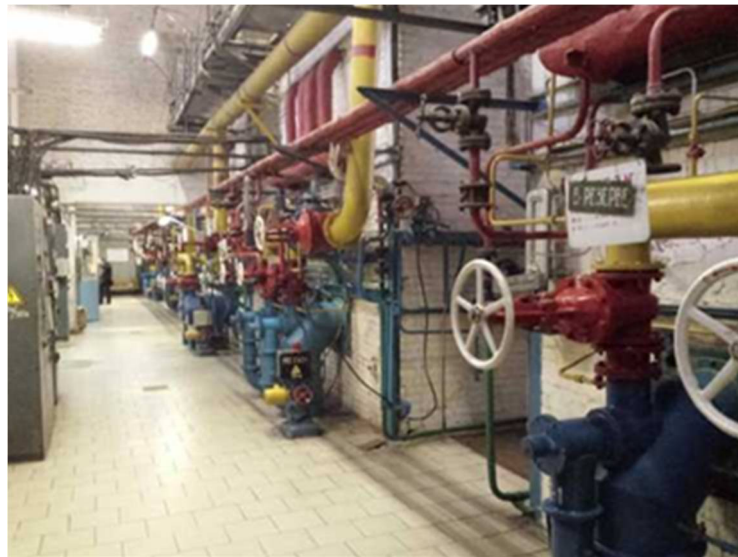
Рисунок 1.8 – Общий вид котельного оборудования котельной №1 АО «Одинцовская теплосеть»
