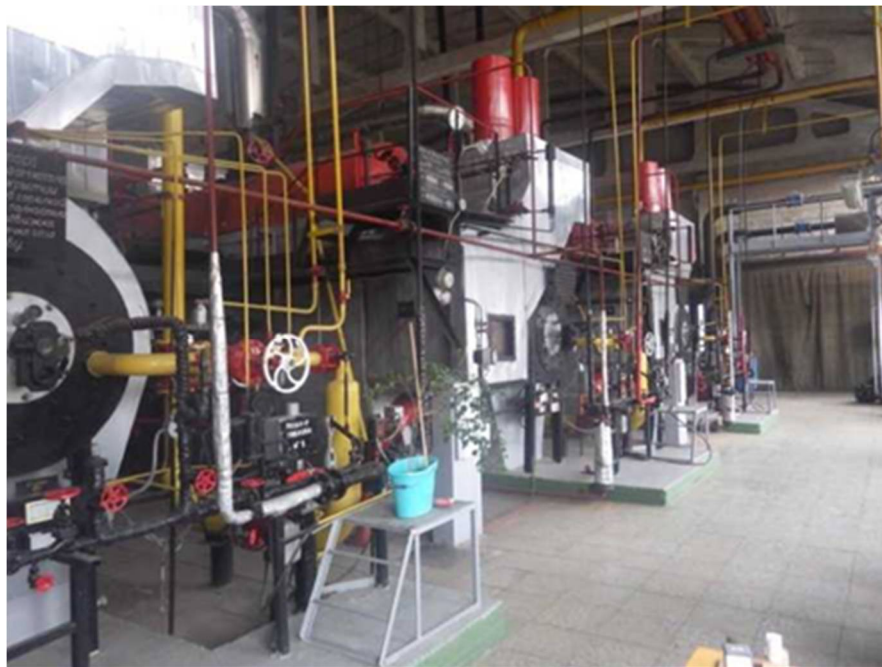
Рисунок 1.37 – Общий вид котельного оборудования котельной ООО «МНЗ»
