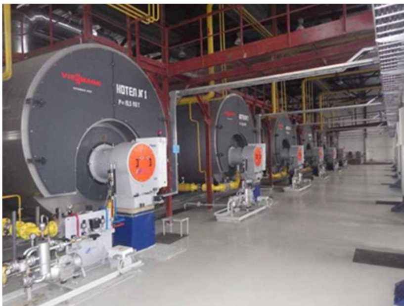
Рисунок 1.42 – Общий вид котлового оборудования котельной «ул. Чистяковой, 30» ЗАО «ГТС»
