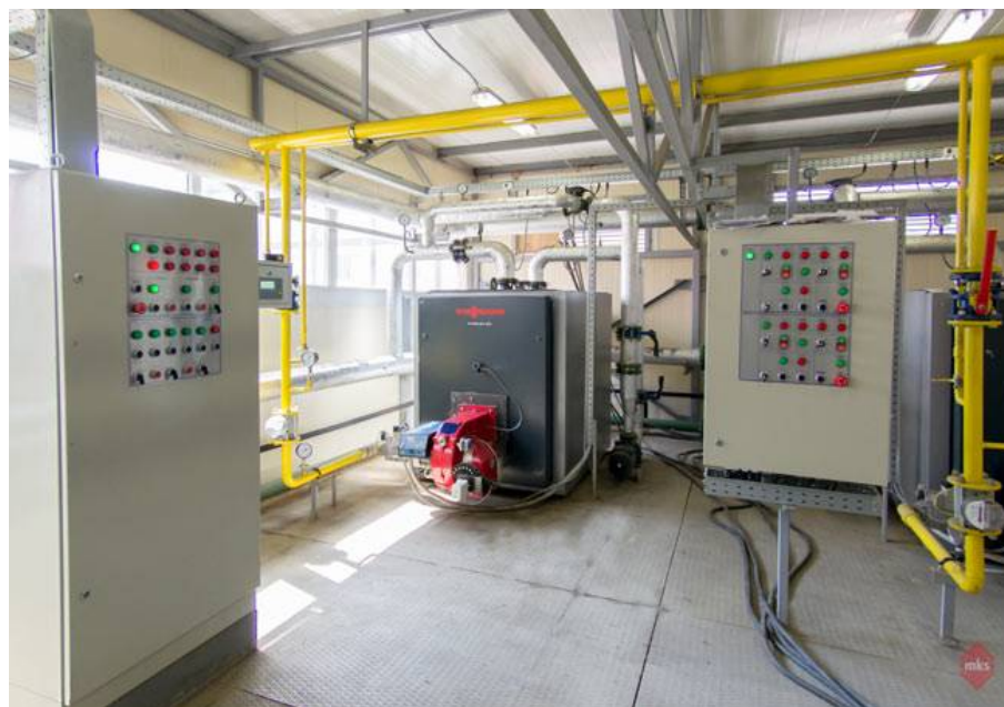
Рисунок 1.49 – Общий вид котельного цеха мини-ТЭС ООО «УНР-858»
