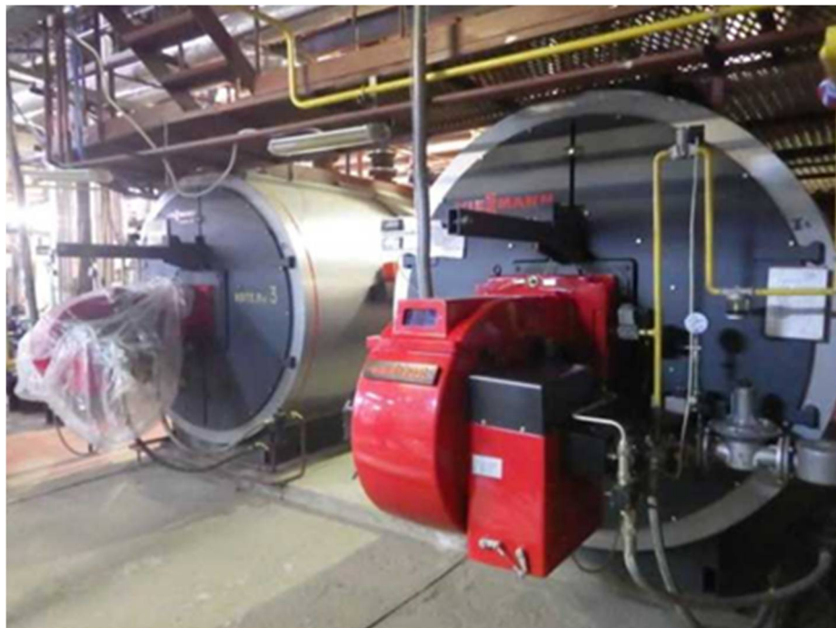
Рисунок 1.47 – Общий вид котельного оборудования котельной №2 АО «Ресурс»
