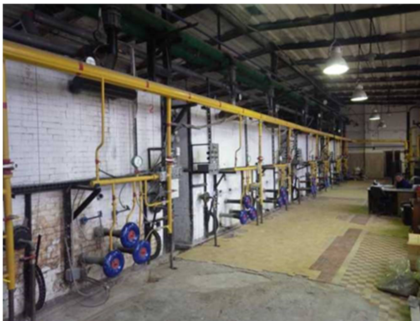
Рисунок 1.27 – Общий вид котельного оборудования котельной «Одинцово-1» АО «Одинцовская теплосеть»
