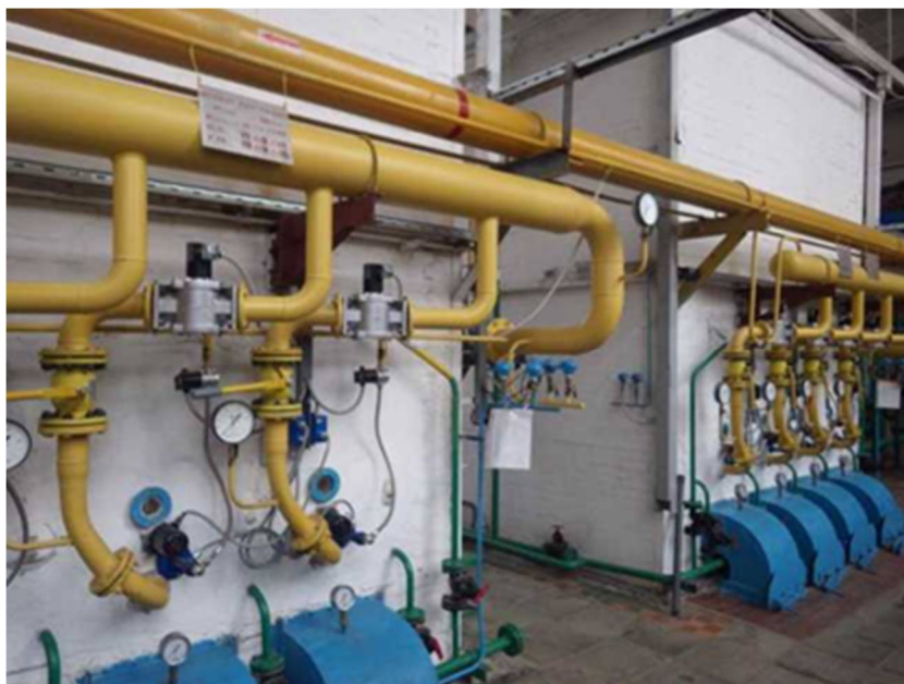
Рисунок 1.18 – Общий вид котельного оборудования котельной №8 АО «Одинцовская теплосеть»
