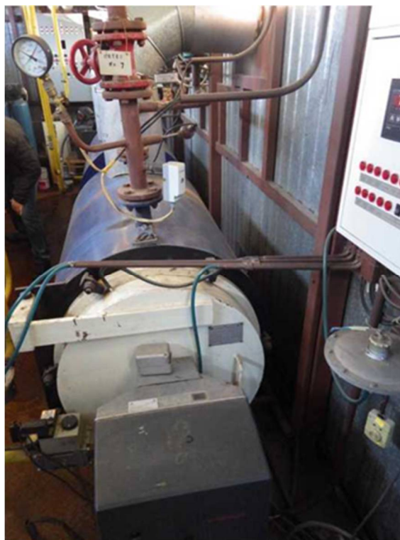
Рисунок 1.31 – Общий вид котлового оборудования котельной «СОЦентр» АО «Одинцовская теплосеть»
