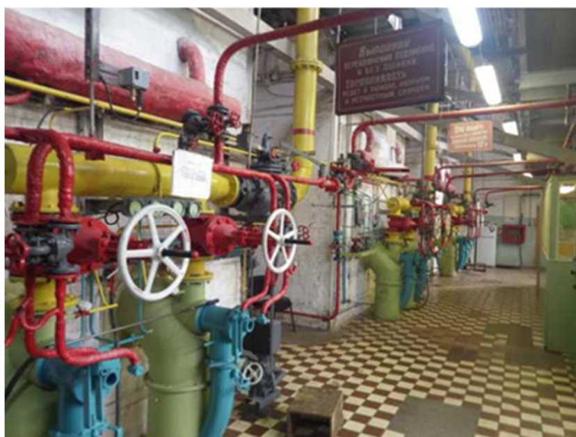
Рисунок 1.10 – Общий вид котельного оборудования котельной №1-а АО «Одинцовская теплосеть»
