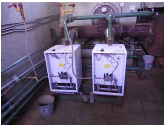
Рисунок 1.33 – Общий вид котлового оборудования котельной «Запрудная» АО «Одинцовская теплосеть»
