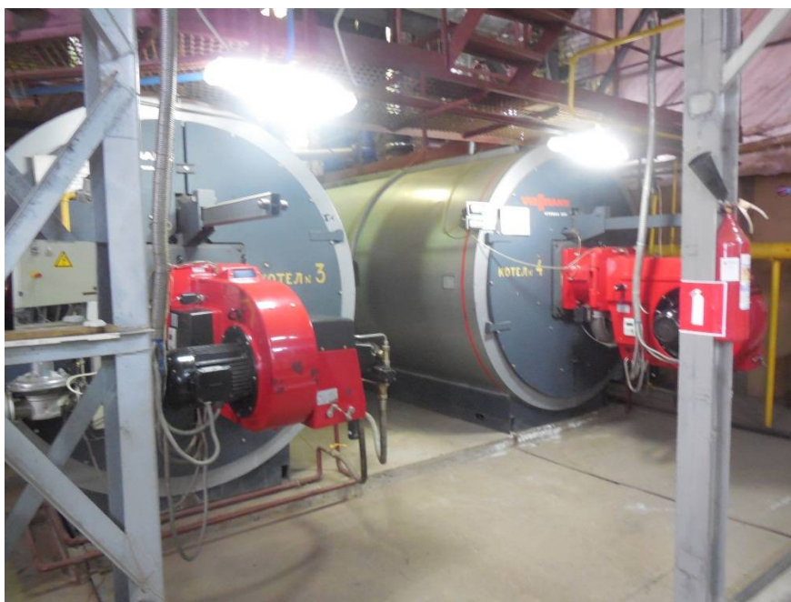
Рисунок 1.44 – Общий вид котлового оборудования котельной ООО «БЗРИ»
