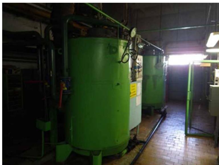
Рисунок 1.25 – Общий вид котельного оборудования котельной Городской бани АО «Одинцовская теплосеть»
