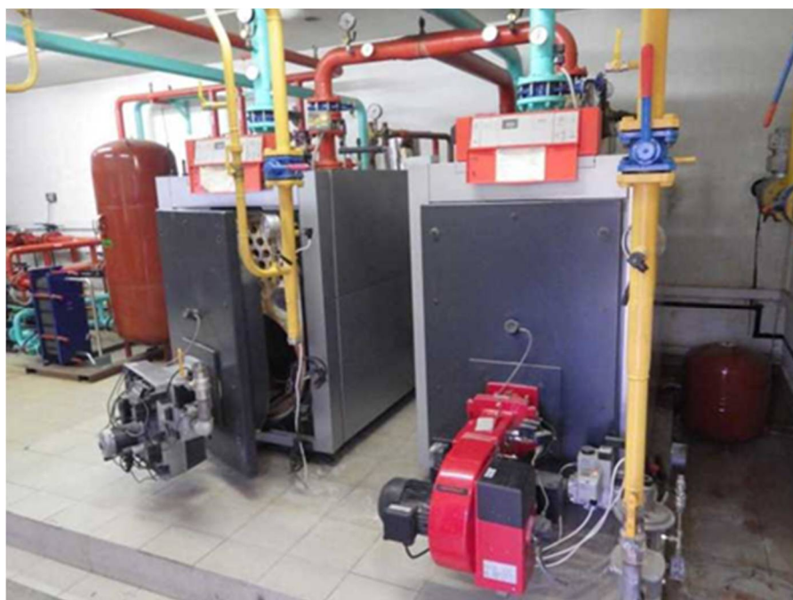
Рисунок 1.29 – Общий вид котлового оборудования котельной д/о «Озера» АО «Одинцовская теплосеть»
