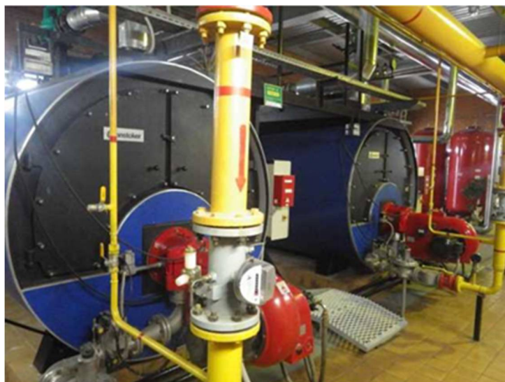
Рисунок 1.22 – Общий вид котельного оборудования котельной «Университет» АО «Одинцовская теплосеть»
