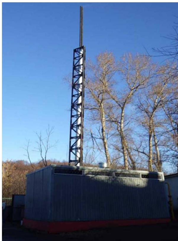
Рисунок 1.30 – Общий вид котельной «СОЦентр» АО «Одинцовская теплосеть»
