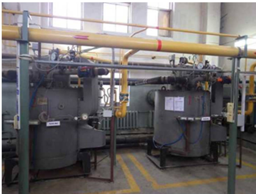
Рисунок 1.39 – Общий вид котельного оборудования котельной №1 ОАО «ВЗОИ»
