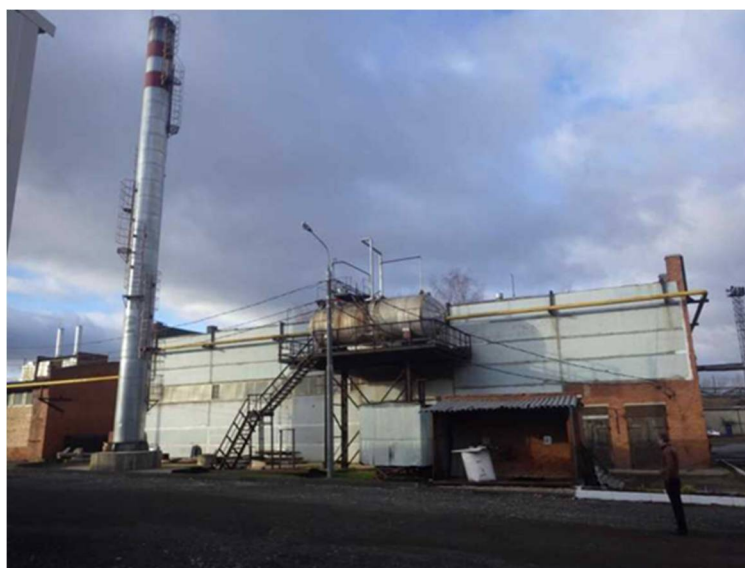
Рисунок 1.19 – Общий вид котельной №8-а АО «Одинцовская теплосеть»
